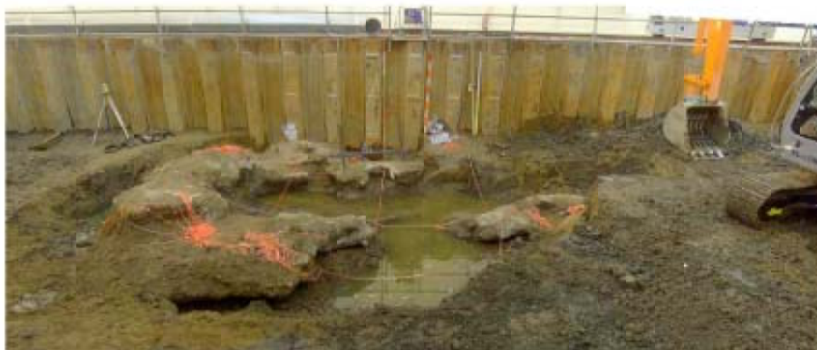
図4 掘削調査において発見されたコンクリート様の塊 (平成17年1月27日)
