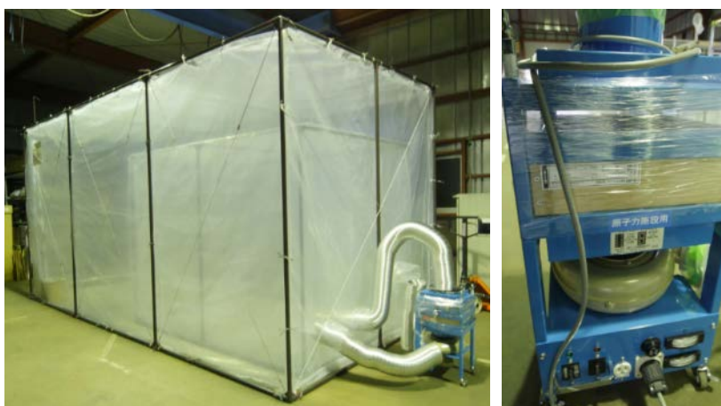
写真 9 2重のクリーンブース(左)とフィルタ付きブロワ(右)
