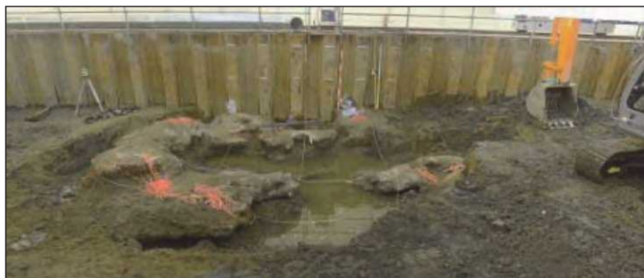
写真 1 汚染源掘削調査により発見されたコンクリート様の塊 （平成 17 年 1 月 27 日撮影）
