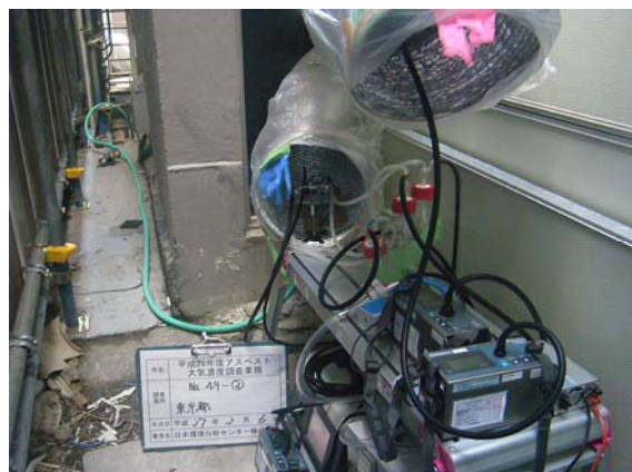
調査地点②(集じん機排気口)
