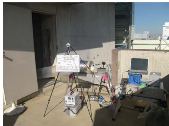
調査地点②(集じん機排気口)
