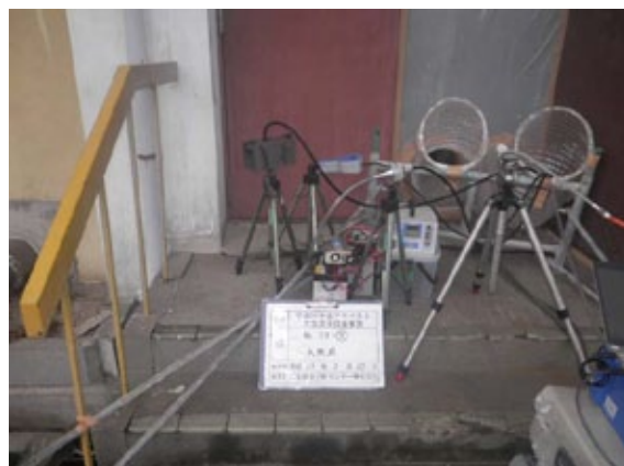
調査地点②(集じん機排気口)
