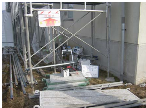
調査地点②(集じん機排気口)
