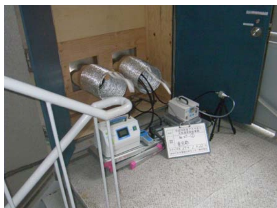
調査地点②(集じん機排気口)
