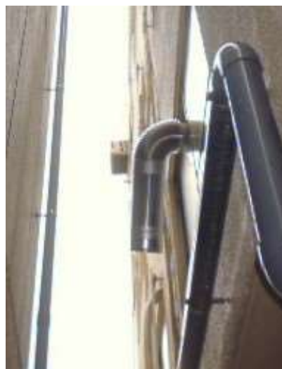
写真2 最終排気口（2階窓から排気）
