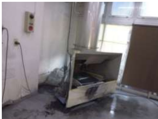
写真1 脱臭装置の外観
