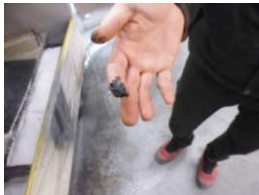
写真2 フィルターに落下した塗料や粉じん等 (開口部幅 1.6m、奥行き 1m)
