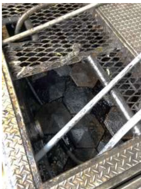
写真3 廃液前処理槽とフロート式六角蓋
