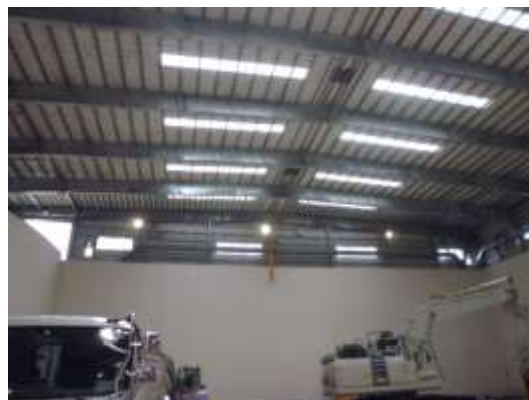
写真4 天井に設置しているルーフファン
