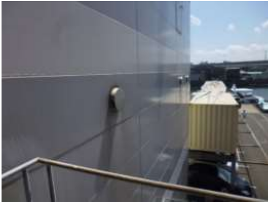
写真5 壁面からの最終排気口
