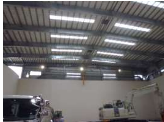
写真4 天井に設置しているルーフファン
