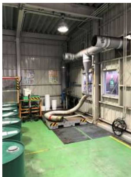
写真4 臭気が強い小分け作業時の局所排気
