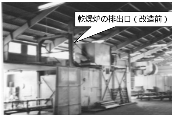
写真2 乾燥炉(臭気対策なし)
