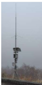
捕獲通知システムの設置状況 (高島市西大切国有林)
