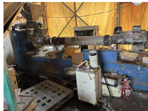
剥き出しのヒーターで火傷の恐れ
