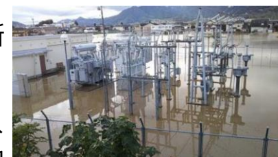
台風により水没した変電所
