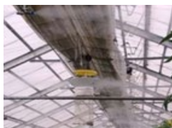
細霧冷房装置
