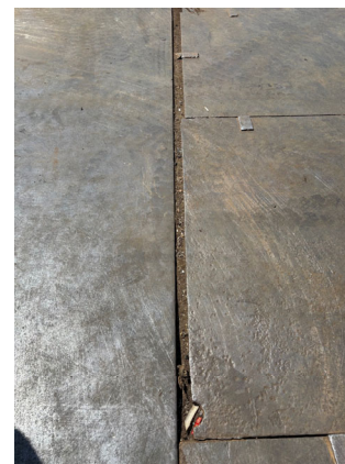
事業場の底面に敷かれた鉄板の隙間
