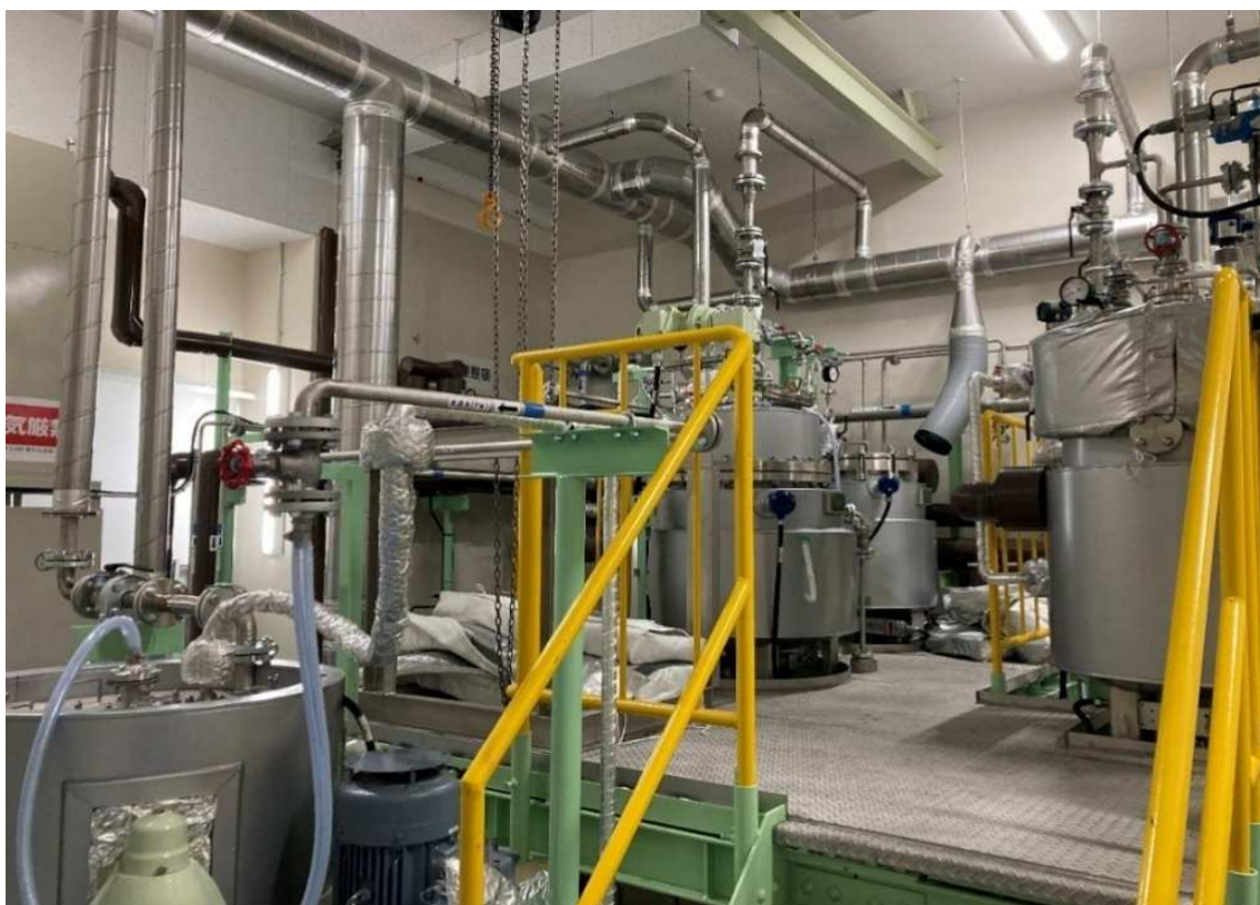
図 11 パイロット設備外観
