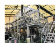
再生材製造設備
