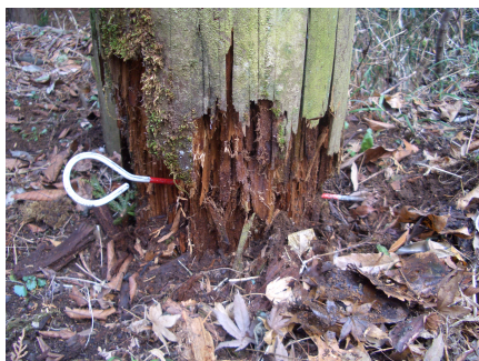
写真2 支柱地際の腐朽
