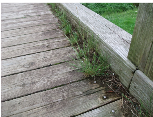
写真 14 デッキの排水性が悪いために植物が生えている
