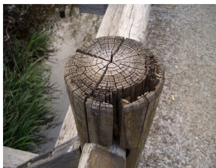
写真3 柱頭部の腐朽
