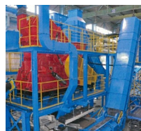
金属破砕・選別設備
