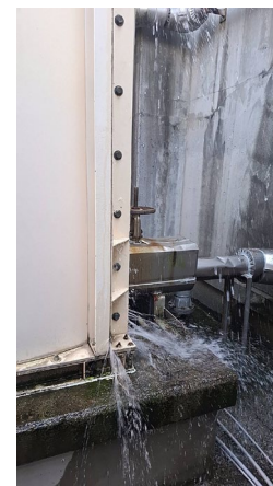
（給排水管の損傷）
