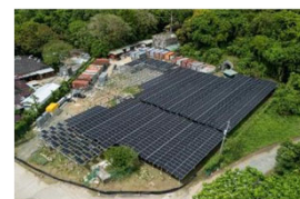
太陽光システムおよび蓄 電池の導入（パラオ） シードおきなわ合同会社
