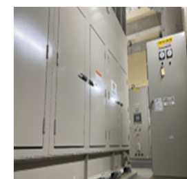
非常用発電装置
