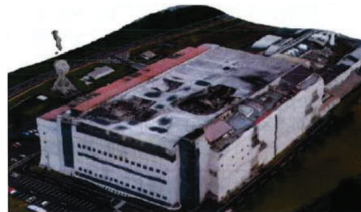
20年10月 宮崎の半導体工場火災 倉庫含む建屋内火災増加
