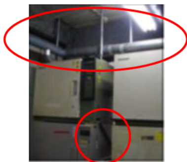
【2段積み恒温器の固定】
