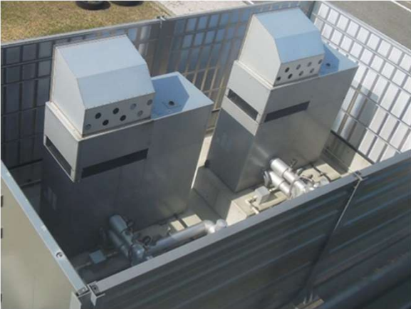
コージェネレーション設備
