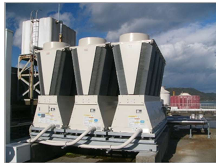
高効率空調設備（チリングユニット）
