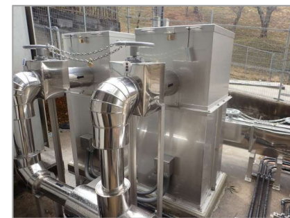
加圧ポンプ 1号(5.5kW), 2号(5.5kW)
