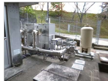
概観 左：加圧ポンプ2基 右：圧力タンク
