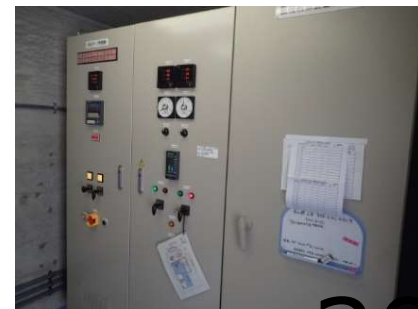
ポンプ制御盤 インバータ機器(5.5kW)
