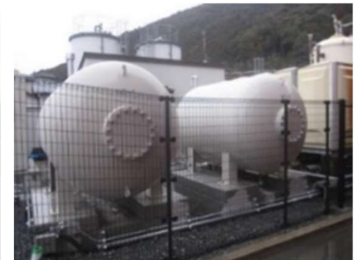
バッファタンク ×2基
