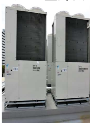
エアコン室外機
