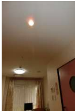
個室のLED照明
