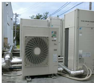
エアコン室外機
