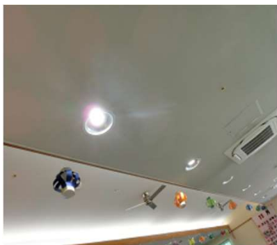
共用部分の照明と空調
