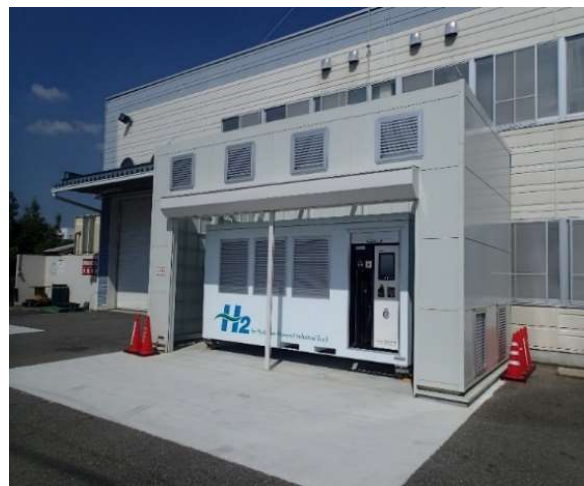
水素ステーション
