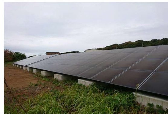
太陽光パネル
