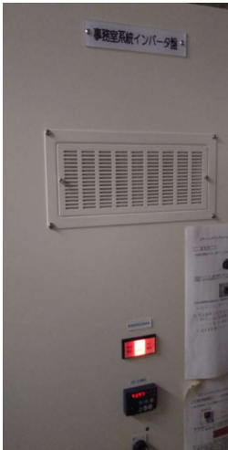
インバータ制御装置
