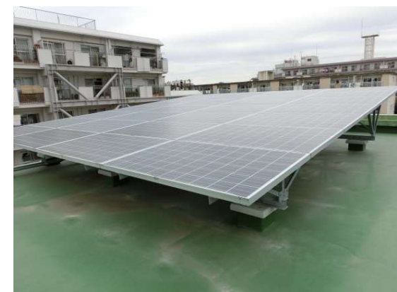
屋上に設置した太陽光発電パネル
