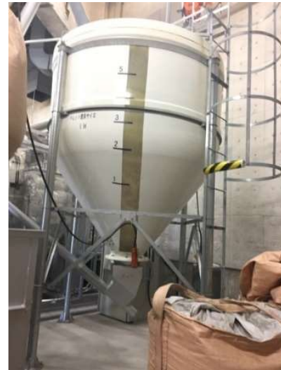
ペレットのストックヤード (サイロ)
