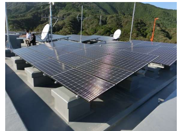
屋上に設置した太陽光発電パネル
