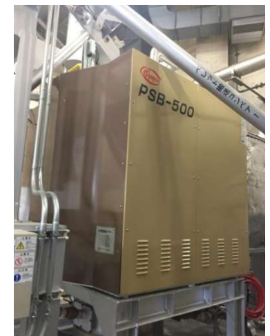
ペレット炊き蒸気ボイラ
