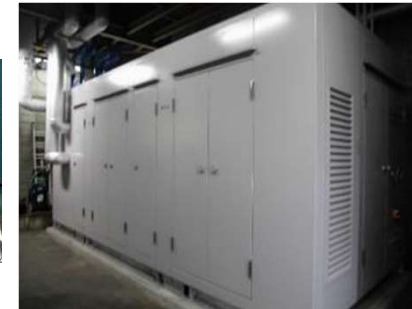
冷凍ユニット。 機械室での設置状況。
