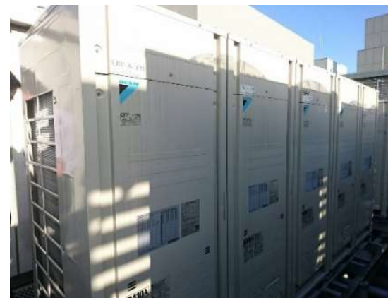
高効率空調(室外機)
