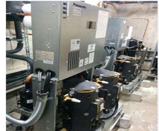
冷凍冷蔵設備
