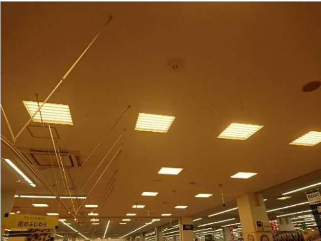
LED照明（室内）
