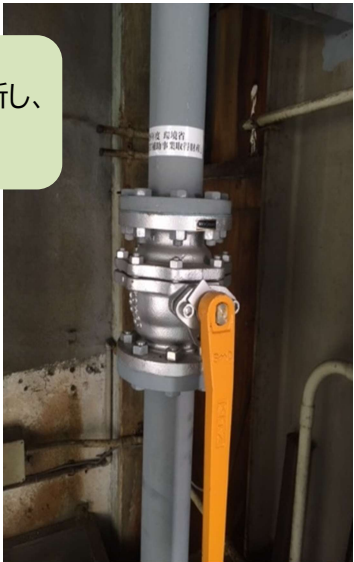
LNG供給用配管
