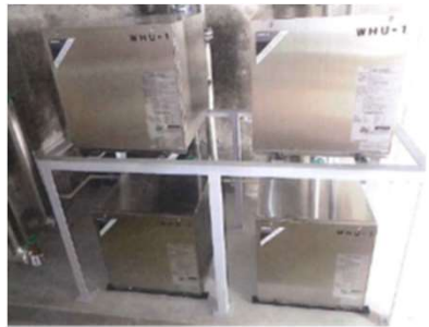
熱利用施設 (ヒートポンプ10kw×5台)
