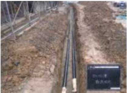
熱輸送施設 (熱輸送管 L=141m)
