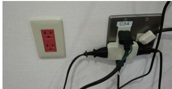
非常用の赤いコンセント
