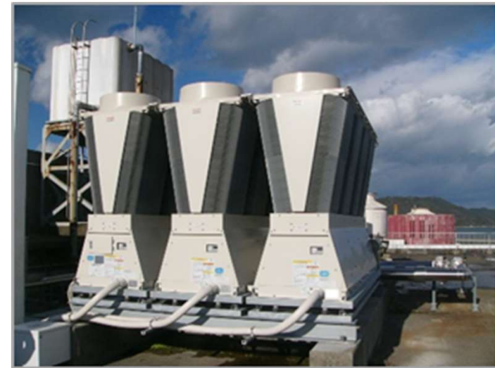
高効率空調設備（チリングユニット）
