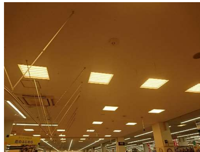
LED照明（室内）
