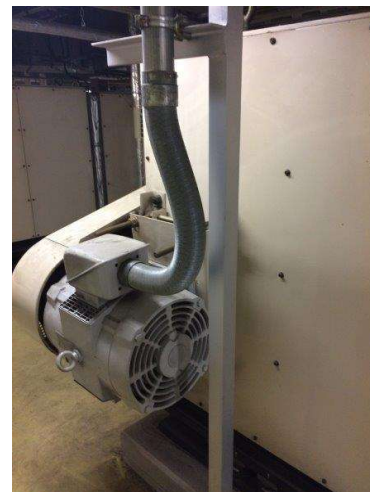
給気ファン (ダクト)
