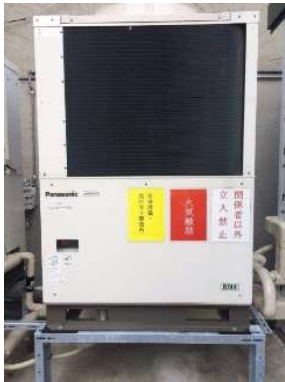
CO 2 冷凍 (室外機)
