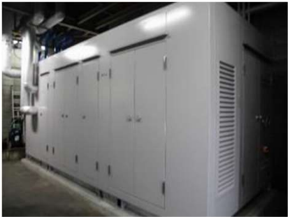
冷凍ユニット。 機械室での設置状況。
