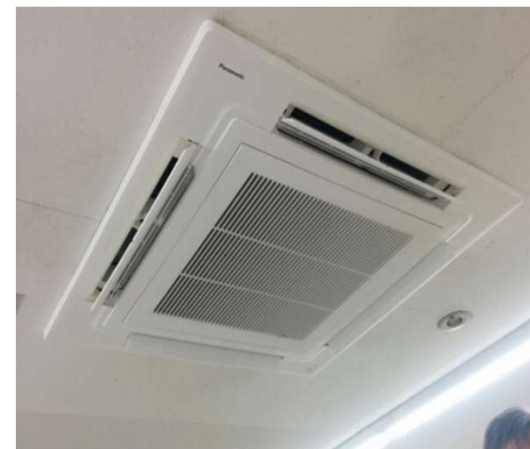
高効率空調設備 (室内機)
