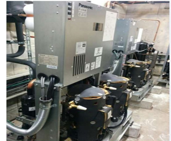
冷凍冷蔵設備
