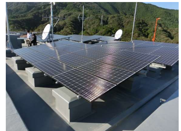
屋上に設置した太陽光発電パネル
