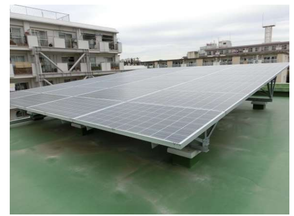
屋上に設置した太陽光発電パネル
