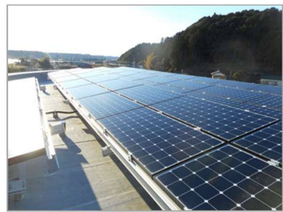
太陽光発電設備
