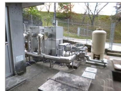
概観 左：加圧ポンプ2基 右：圧力タンク
