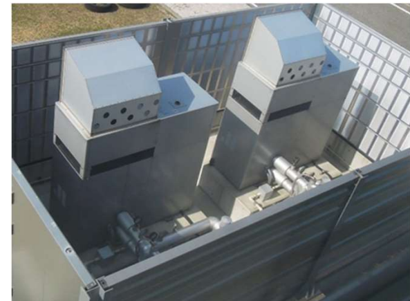
コージェネレーション設備
