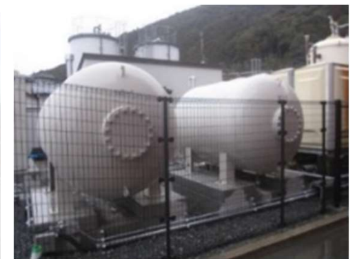
バッファタンク ×2基
