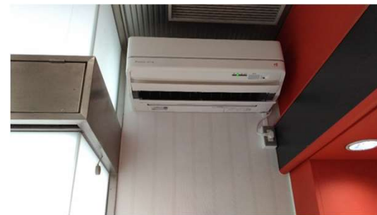
高効率空調設備
