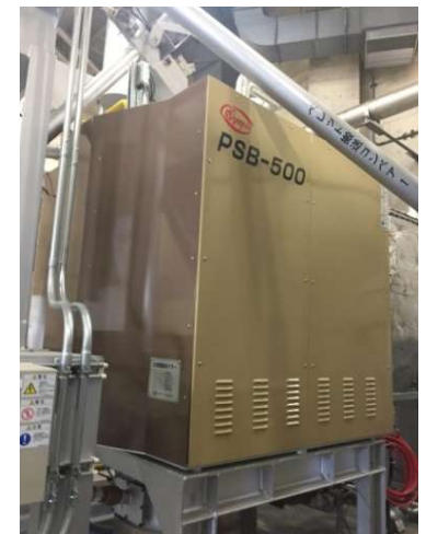
ペレット炊き蒸気ボイラ
