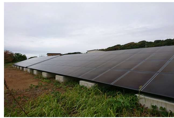
太陽光パネル
