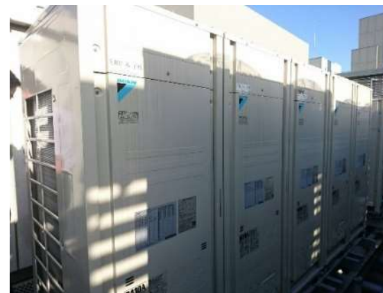
高効率空調(室外機)
