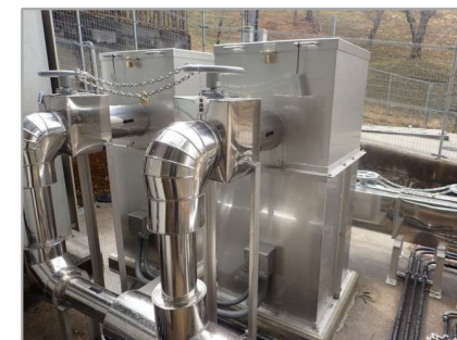
加圧ポンプ 1号(5.5kW)、2号(5.5kW)
