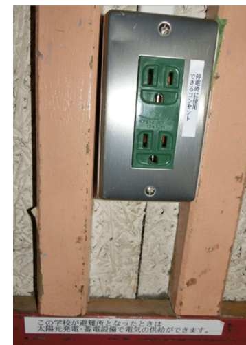
非常用の緑色コンセント (体育館)
