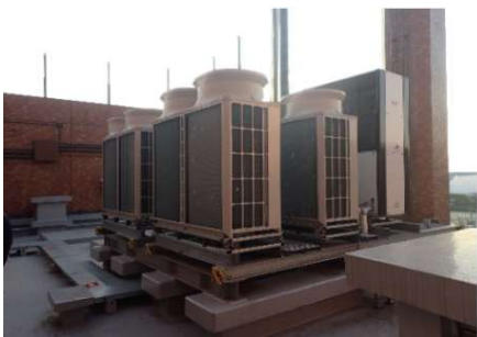
高効率空調設備
