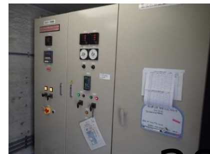
ポンプ制御盤 インバータ機器(5.5kW)
