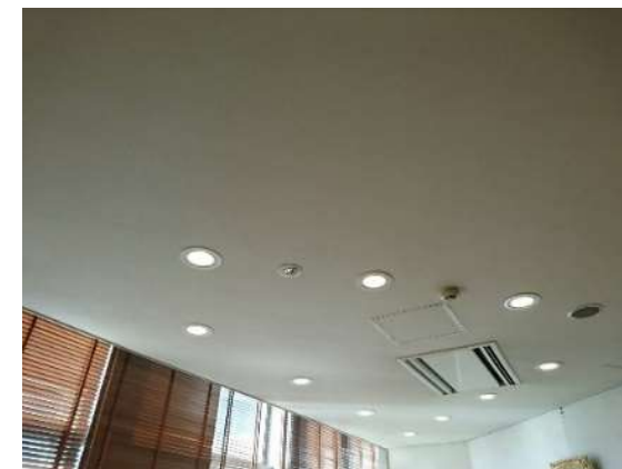
高効率空調(室内機)
