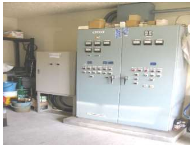
配電盤とインバータボックス
