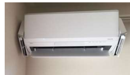
エルームエアコン室内機
