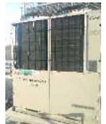
冷凍機 (CO 2 ) : 屋上に設置。
