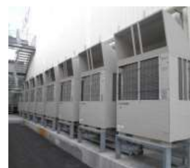
冷凍機： 架台の上に載せて通気性を向上させている。
