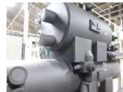
冷凍機：機械室内の設置。
