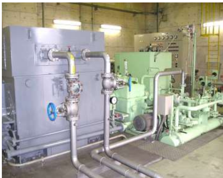
蒸気タービン発電機（背圧式）
