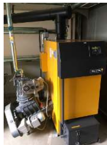
バイオマス（木質ペレット）ボイラー
