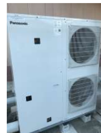
冷凍機（室外機）
