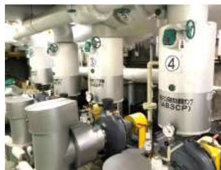
冷水・冷却水ポンプ
