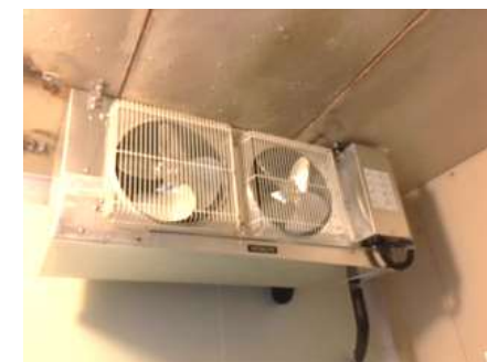
バックヤード冷凍冷蔵庫
