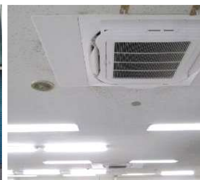
空調設備（室内機）とLED照明
