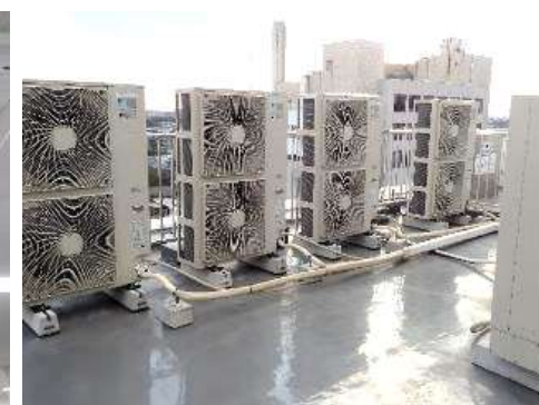
空調設備（室外機）
