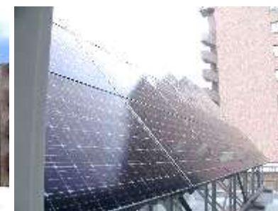
太陽光発電システム
