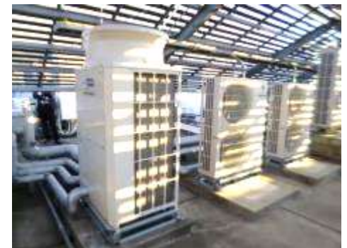
高効率空調（室外機）
