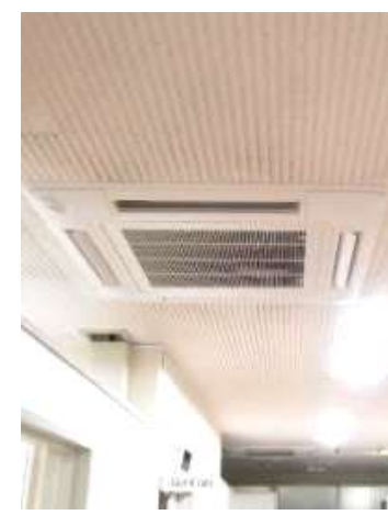
空調設備（室内機）とLED照明
