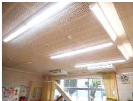
空調設備とLED照明（小学校）
