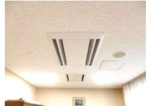
高効率空調（室内機）とLED照明
