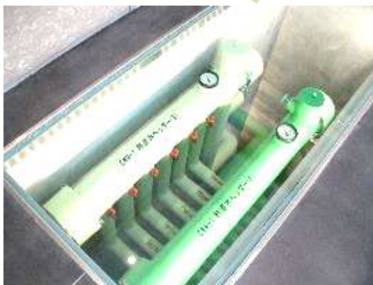
床下の地中熱システム
