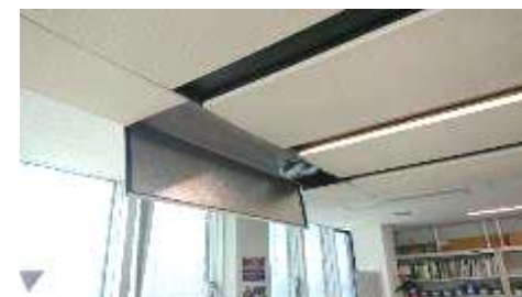
空調システム（空調ダクトパネル）
