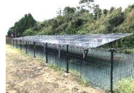
太陽光パネル (2)
