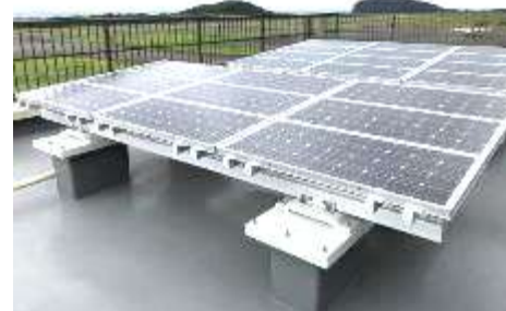
太陽光パネル (1)
