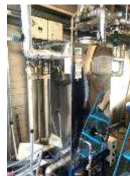
排熱(水)回収設備
