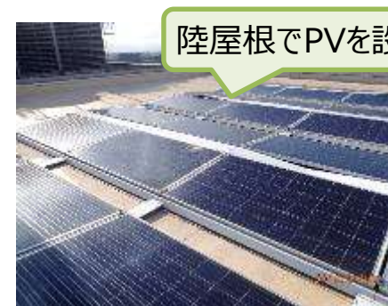
陸屋根上 太陽発電パネル
