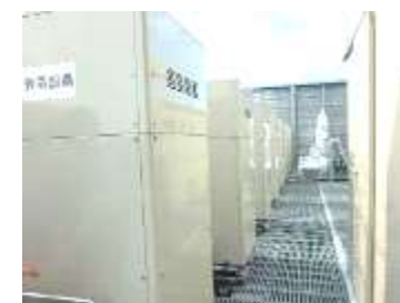
屋上に設置されたコジェネ8台
