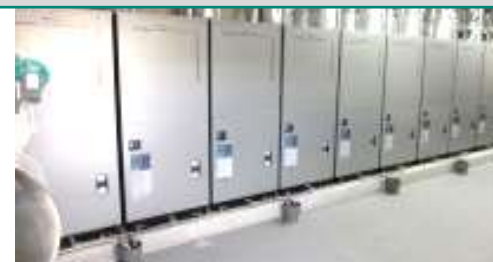
ヒートポンプ8台 （融雪用HPも合わせて設置）
