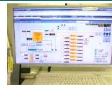
中央監視室の監視画面
