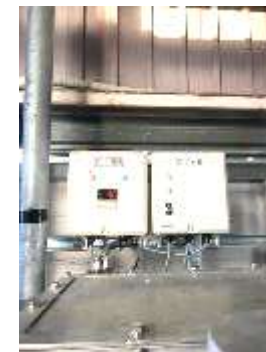
温度計・給水装置スイッチ
