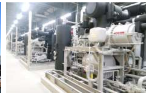
冷凍機：屋内機械室に冷凍機を設置
