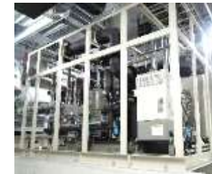
冷凍機 (NH 3 /CO 2 ) : 機械室内の設置。
