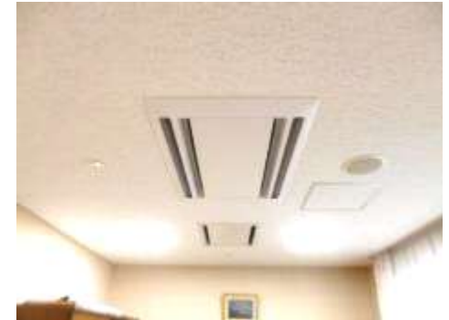
高効率空調（室内機）とLED照明
