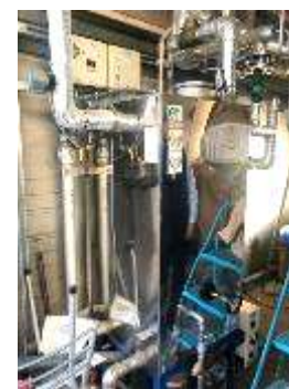
排熱(水)回収設備
