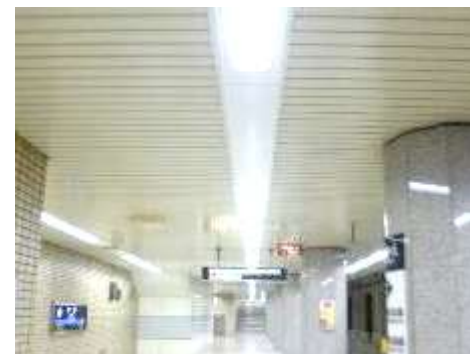
調光していないホームのLED照明
