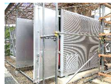
潜熱回収温水ヒーター（室外機）
