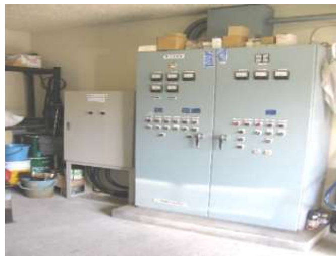
配電盤とインバータボックス
