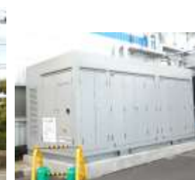
冷凍機： 屋外地上に設置。
