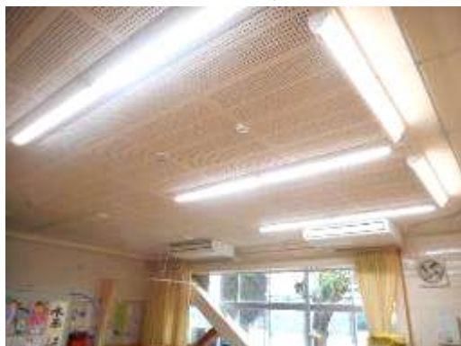
空調設備とLED照明（小学校）
