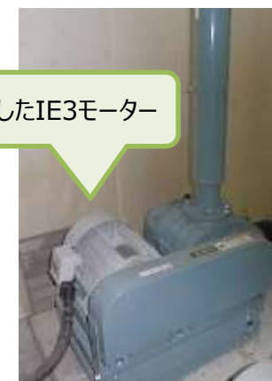
3次処理曝気ブロワー
