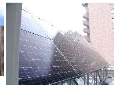
太陽光発電システム
