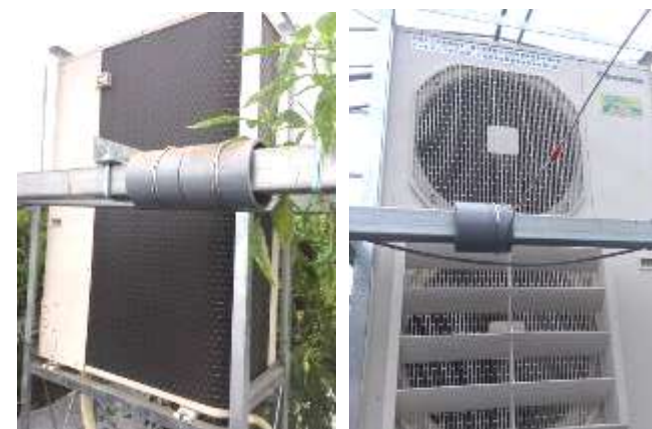
空調設備室内機
