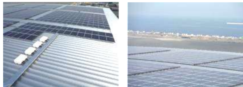
太陽光発電パネル (工場屋上)
