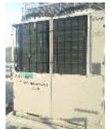
冷凍機 (CO 2 ) : 屋上に設置。
