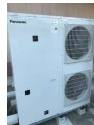
冷凍機（室外機）
