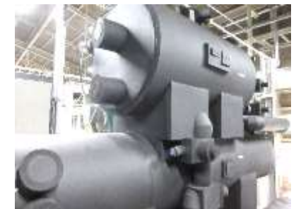
冷凍機 : 機械室内の設置。
