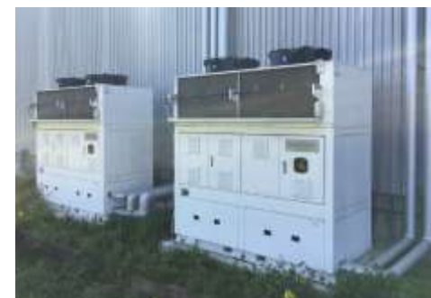
冷凍機：屋外地上に設置。
