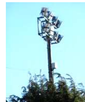
グラウンドの照明（中学校）
