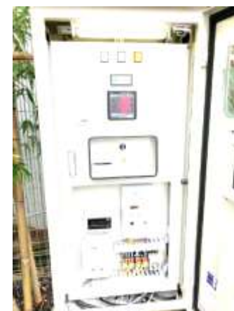
融雪設備(内部)
