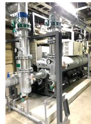
ターボ冷凍機
