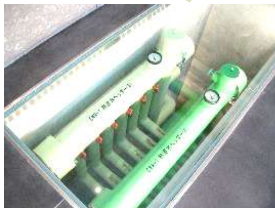
床下の地中熱システム
