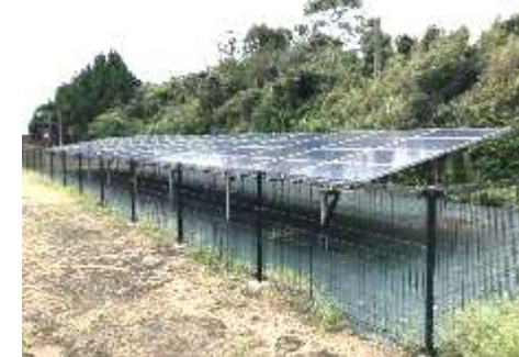
太陽光パネル (2)
