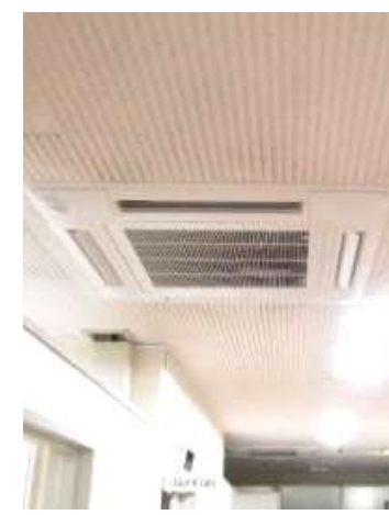
空調設備（室内機）とLED照明
