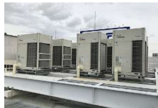
空冷ヒートポンプエアコン （室外機）
