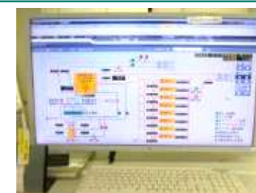
中央監視室の監視画面
