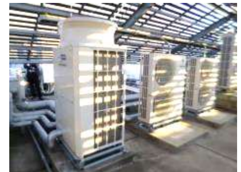
高効率空調（室外機）
