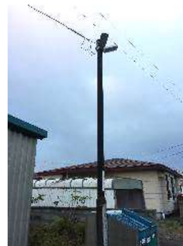
LED照明（白老町）
