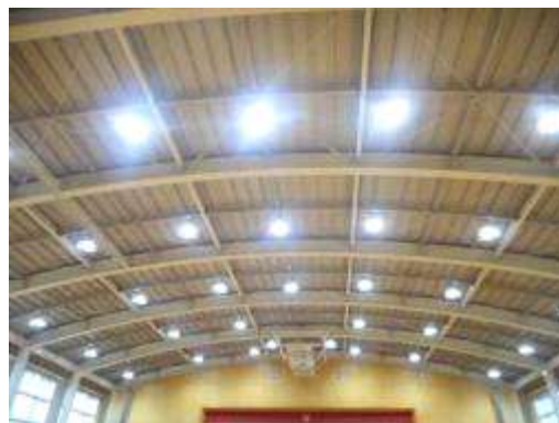
体育館のLED照明（小学校）
