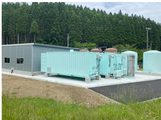
図 79 設備の外観①
