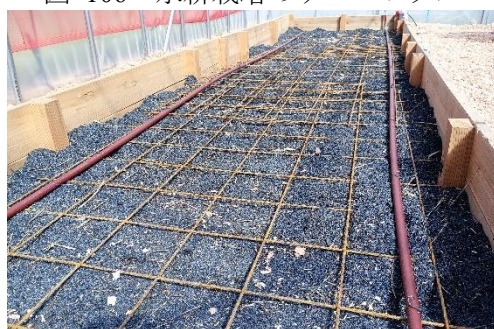
図 108 温水パイプの熱を土中全体に行き渡らせるためのワイヤーメッシュ
