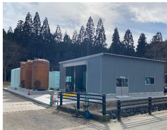
図 80 設備の外観②
