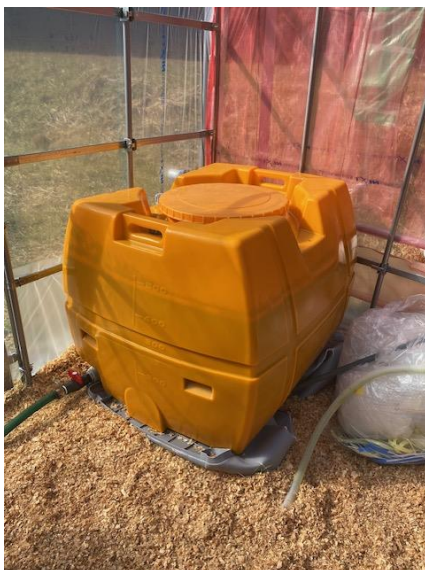
図 97 温室内に設置した ローリータンク
