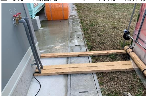
図 107 プラントから温水を引き込むための温水パイプ
