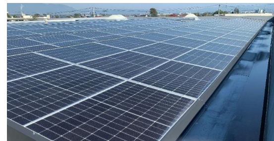
太陽光発電設備
