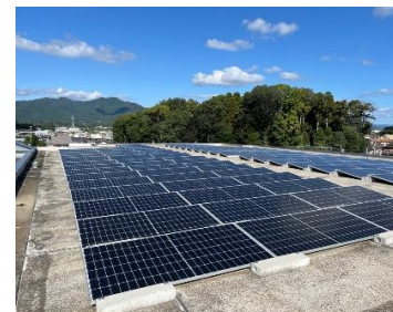
太陽光発電設備
