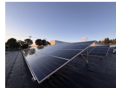
太陽光発電設備
