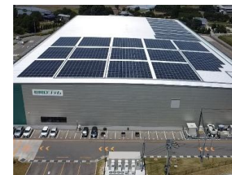
太陽光発電設備
