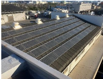
太陽光発電システム
