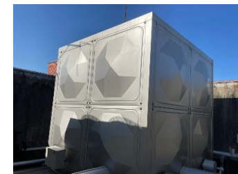
開放型貯湯槽
