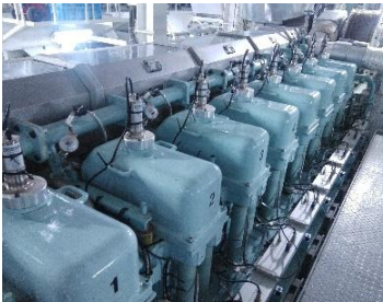
LNG専焼ガスエンジン
