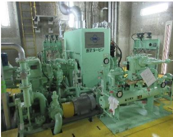
蒸気タービン
