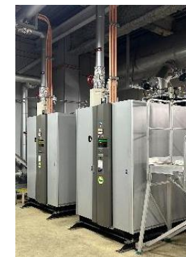
ガス焚き蒸気ボイラ
