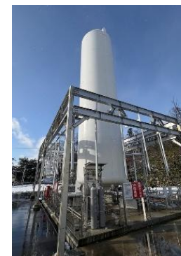
LNGサテライト
