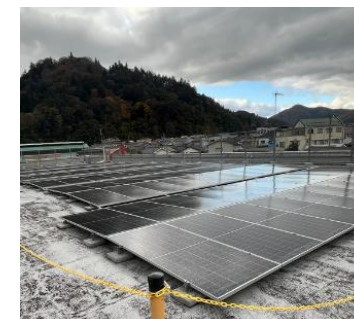
太陽光発電設備
