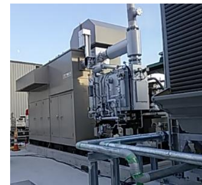
コージェネレーション設備
