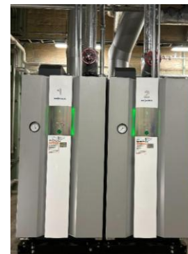
ガス炊き蒸気ボイラ
