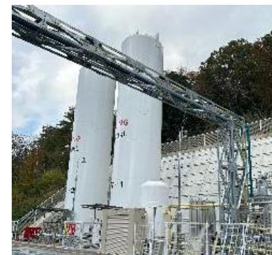
LNGサテライト
