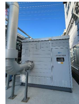
ガス炊き吸収式冷温水製造装置
