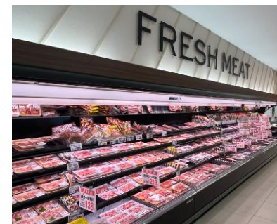
冷蔵冷凍設備
